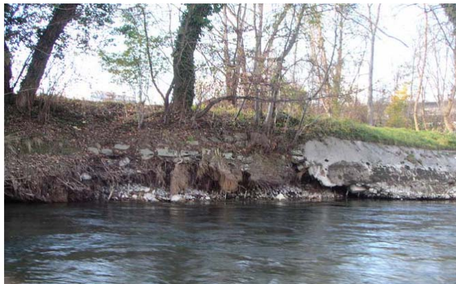
18.11.2005, Marzili, Höhe Gaswerkareal, Uferschutz zerfallen, Ufer unterspült
